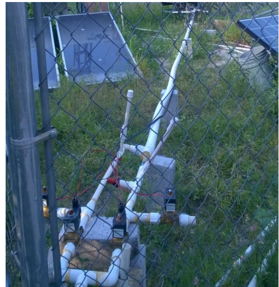
Figura 5 Intercambiador de calor con electroválvulas hidráulicas para el control de flujo de agua.
