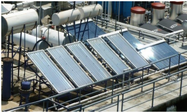
Figura 2 Sistema de colectores ubicados en la plataforma solar del IER-UNAM.
