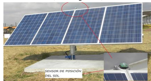
Figura 4 Seguidor solar dos ejes 1 kW de potencia.
