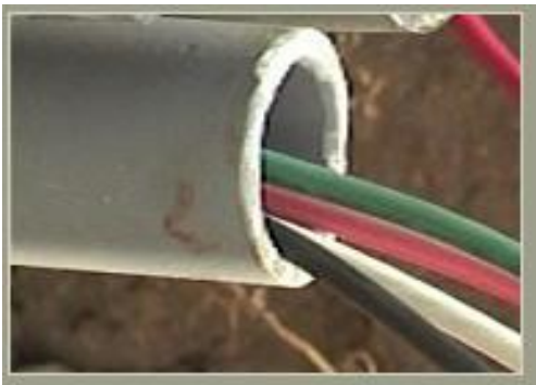
Figura 5 Cableado por el interior de los tubos.
