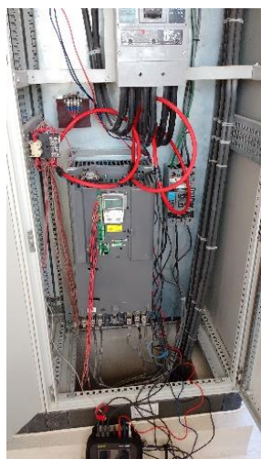
Figura 3 Analizador de redes instalado Fuente: Foto Propia
