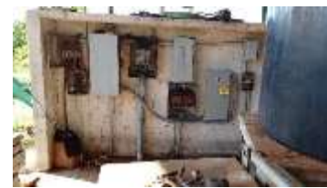
Figura 3 Banco de capacitores en operación
