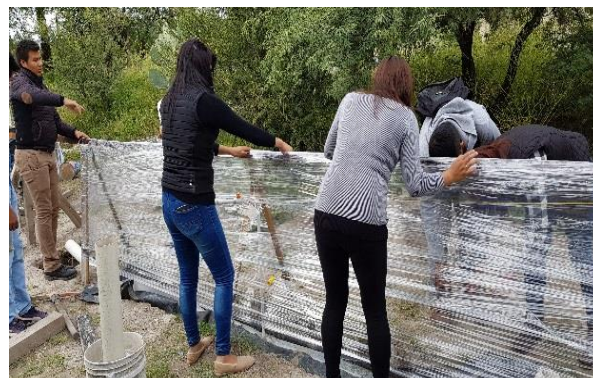
Figura 5 Se pone un invernadero al biodigestor para que la temperatura se mantenga constante en el biodigestor
