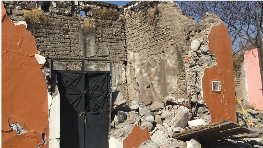
Figura 15 Vivienda de Huaquechula, sismo septiembre 19 del 2017. (VÁZQUEZ, 2018)
