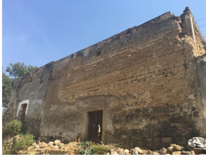
Figura 12 Vivienda de Tochimilco, sismo septiembre 19 del 2017. (VÁZQUEZ, 2018)
