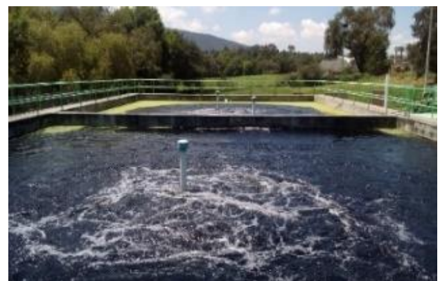
Figura 8 Clarificador Fuente: Elaboración Propia
