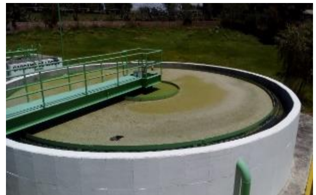
Figura 7 Clarificador Fuente: Elaboración Propia
